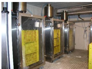
Komory chłodnicze z kontrolowaną atmosferą
