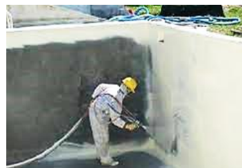
Zbiorniki na gnojowicę
